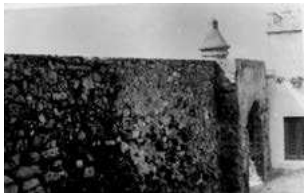
Figura 11, a y b. Estado del paramento interno de la coracha antes de su reparación en 1956 (Expediente militar).
